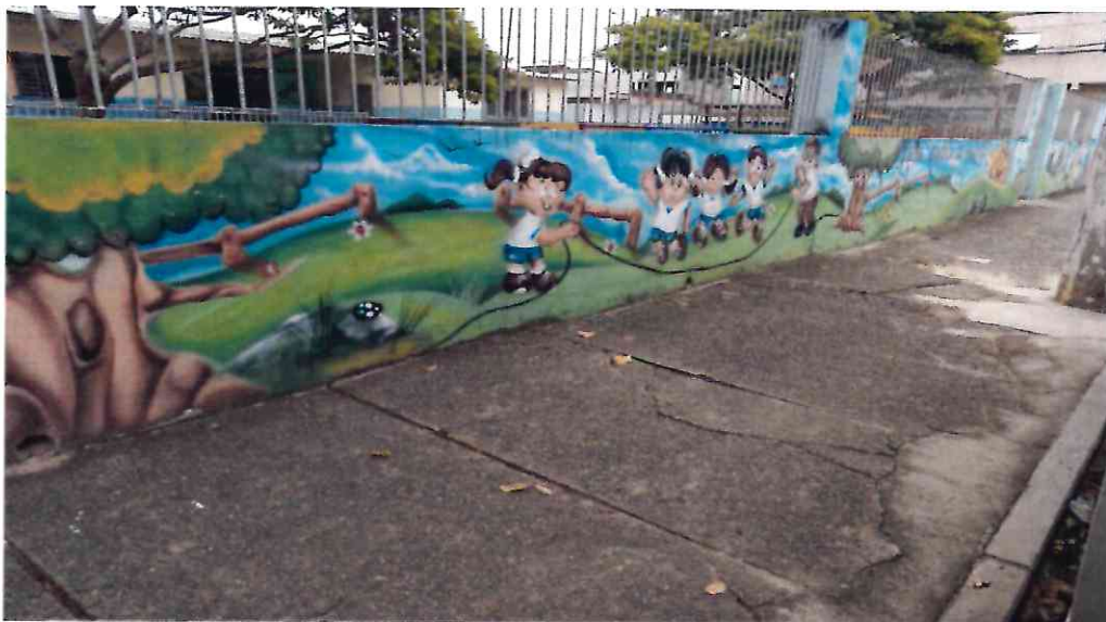
RACHADURAS DA CALÇADA EXTERNA DO CEIM “ENOCK DE FREITAS”
