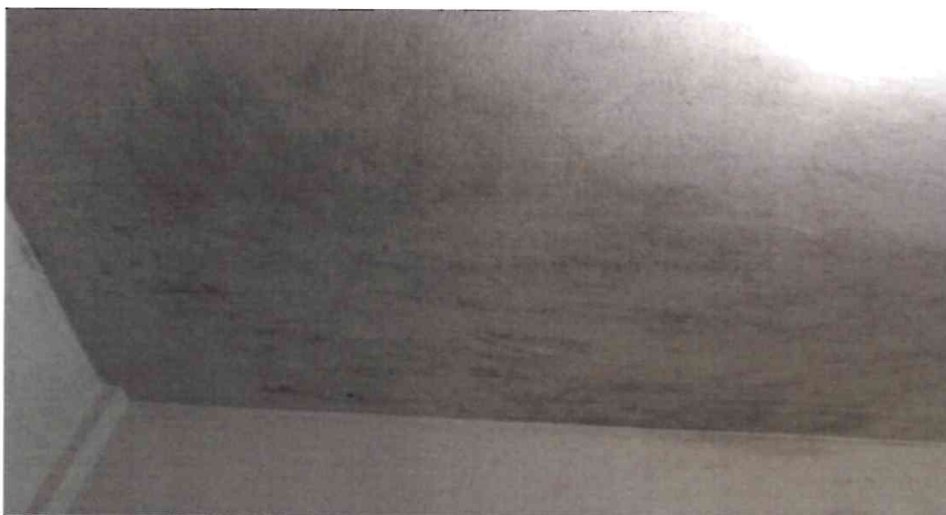
MOFO OCASIONADO POR INFILTRAÇÕES NO TETO
