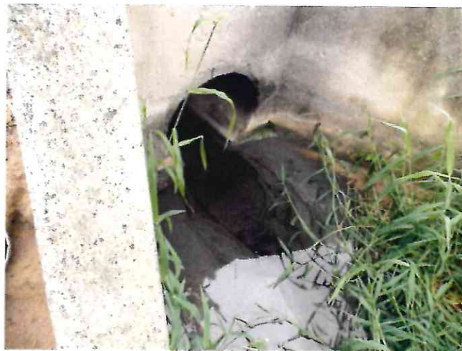
Figura 03: Rede pluvial despejando óleos e graxas na lagoa do Aviso (UTM: 390772/7854692).
