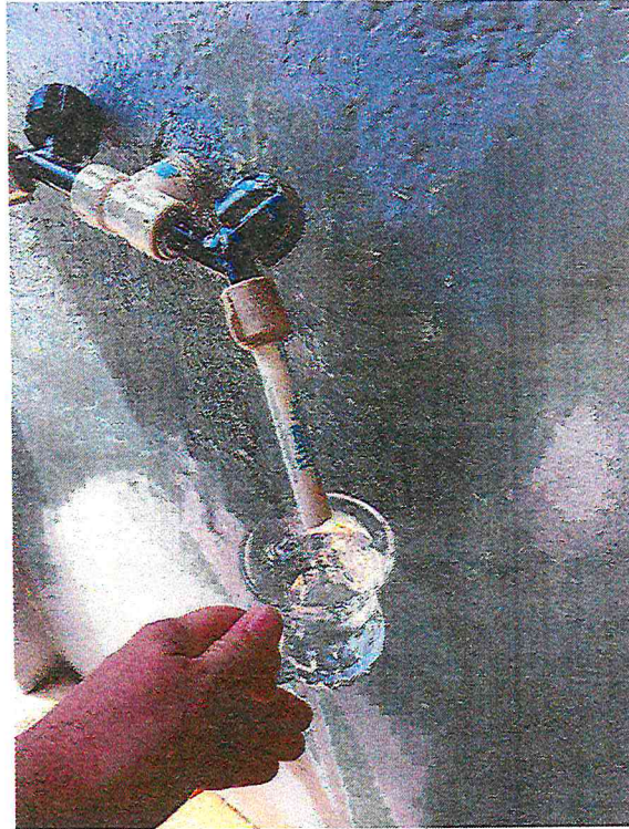
Torneira de entrada da EMEF
